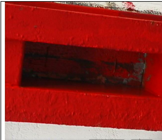
Fig. 1. Área de difícil acceso entre dos vigas. Observe la corrosión en su interior.
