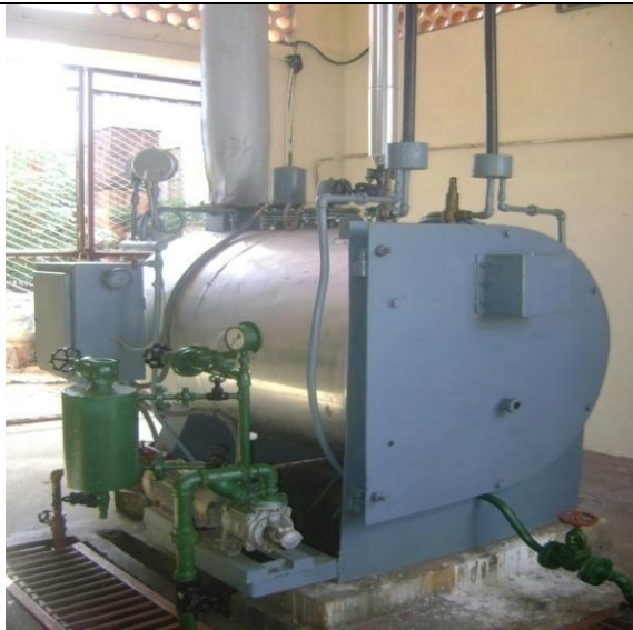
Generador de vapor de tubos de fuego.
