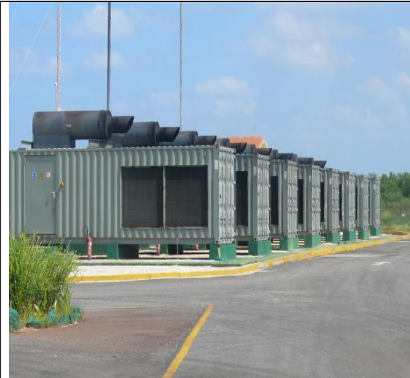
Línea 1. Central Eléctrica Diesel de Varadero
