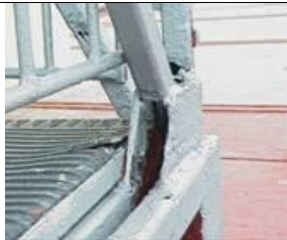
Fig. 2 Cartabones de refuerzo con área sin acceso. Observe la corrosión interior
