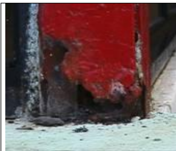
Fig. 5. Área cerrada del interior de un perfil rectangular. Observe la corrosión.
