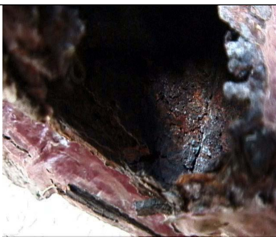
Fig. 6. Área cerrada de un perfil rectangular hueco. Observe la corrosión en el interior.
