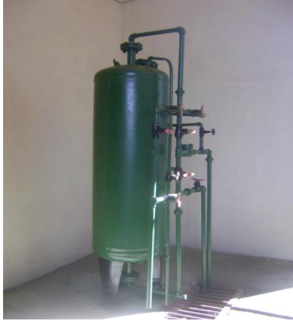
Intercambiador catiónico ciclo sodio para el suavizado de agua.
